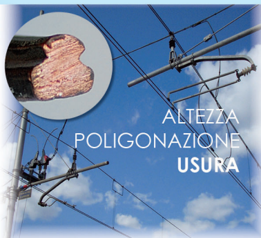
misura della LINEA ELETTRICA
