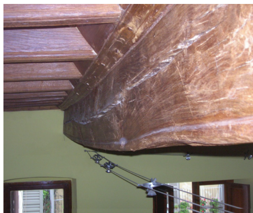
Foto 2 - Trave in legno fessurata longitudinalmente. Wooden beam creviced longitudinally.
