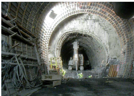
Fig. 1 – Le rocce spingenti riducono la sezione della galleria. La foto scattata all'interno della discenderia di Saint Martin La Porte, relativa al tunnel di base della linea Torino - Lione, mostra in modo particolarmente evidente tale fenomeno, che ha comportato la riprofilatura del cavo. Squeezing rock reduces the tunnel cross section. This is shown dramatically in this photograph taken at the Saint Martin La Porte access tunnel along the Lyon-Turin Base tunnel, where re-profiling of the highly deformed cross section took place.
