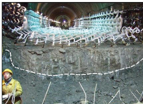
Fig. 9 - L'arco rovescio esistente messo in luce dallo scavo del concio contiguo. The excavation of the existing invert.
