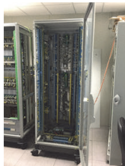
Fig. 7 - Rack con circuiti e componenti OTC.
