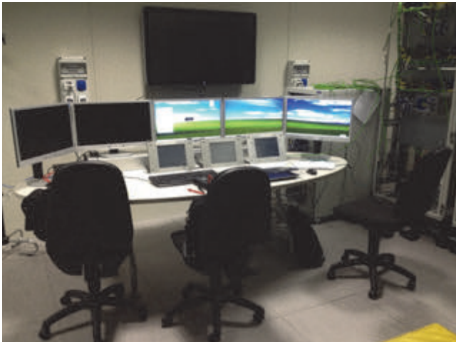
Fig. 1 - Postazione di controllo del Soft Train. Fig. 1 - Soft Train control station.
