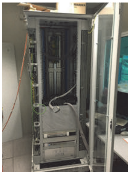
Fig. 6 - Rack per ospitare le centraline Terze Parti.
