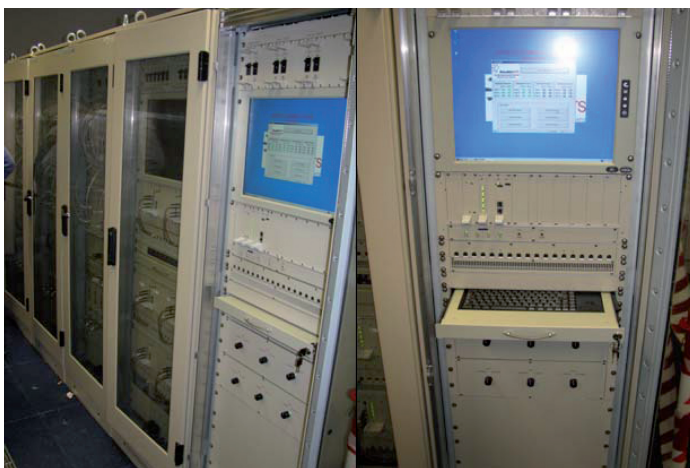
Fig. 1 - RBC Ansaldo relativo alla tratta AV/AC Milano Bologna e suo apparato di commutazione verso l'impianto ridondato denominato "RBC Specchio". Ansaldo RBC controlling the HS/HC Milan-Bologna line and its equipment for switching towards the back up plant named "Mirror RBC".
