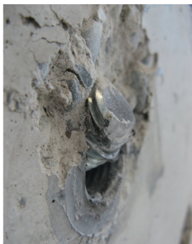
Fig. 15 - Modalità di rottura a carichi elevati. Failure mode with heavy loads.
