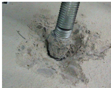
Fig. 16 - Modalità di rottura a basso carico. Failure mode with low loads.
