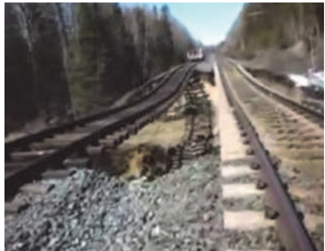
Fig. 5 - Vulnerabilità funzionale: a seguito di un evento rilevante: uno dei due binari risulta danneggiato riducendo la capacità della linea.
